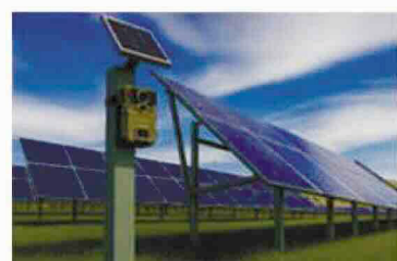
太陽光発電所の盗難対策
